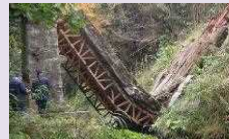
香川・徳島県境無名橋の落橋 (2007年)
